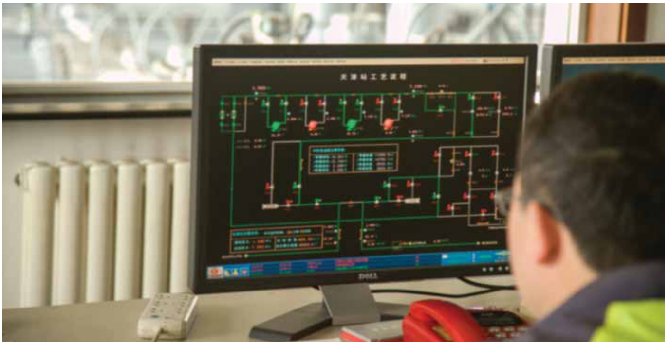
TSN-PEKCL Pipeline's control room operations 天津管输公司监控室运作
